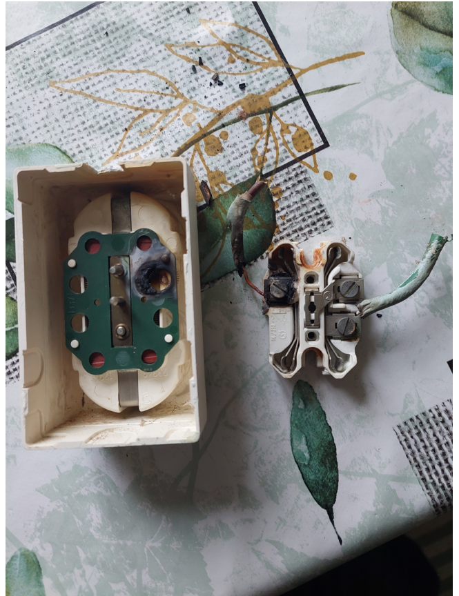
Kuva 7. Keittiön pistorasia, joka on alkanut todennäköisesti löysän liitoksen vuoksi savuamaan.
