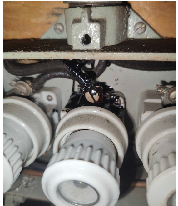
Kuva 18. Keskuksessa pääsulakkeiden päälle valunutta epämääräistä mustaa ainetta.
