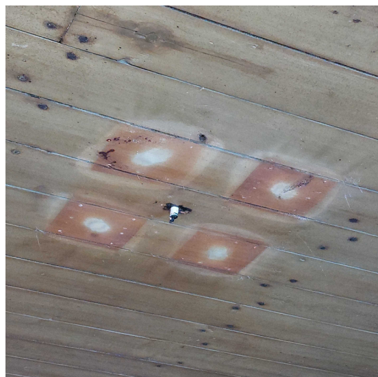
Kuva 15. Valaisimien aiheuttama tummentuma katossa.
