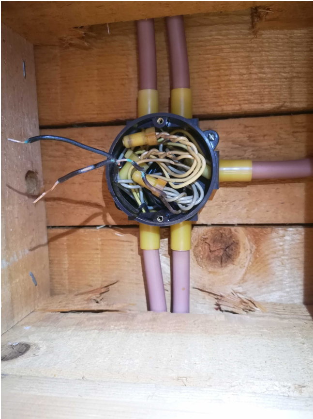
Kuva 6. Jakorasiassa tummuneita johtimia, joiden eristeet murenevät.
