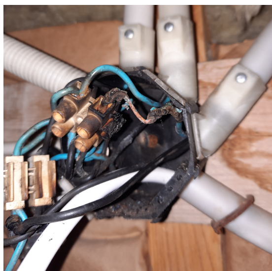
Kuva 16. Löysästä liitoksesta johtunut palon alku.
