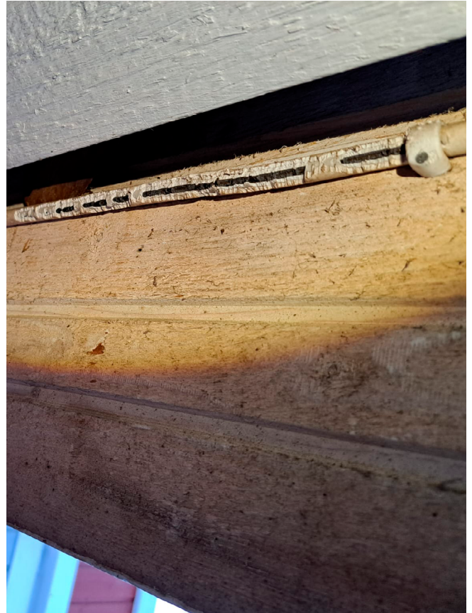
Kuva 2. Jyrsijän syömä kaapeli.
