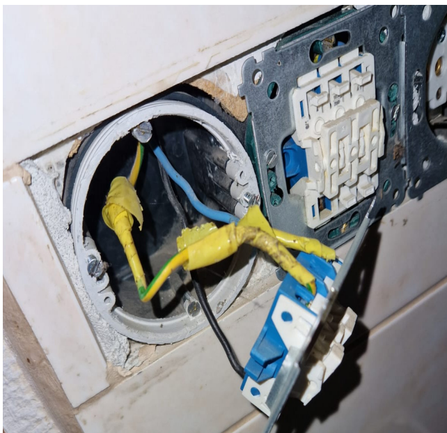
Kuva 28. Avoin kytkentärasia — keviä käytetty vaihejohtimena.
