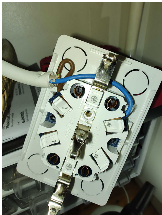
Kuva 19. Kelluva maadoitus — pistorasia josta maadoitusliitin on irrotettu standardien vastaisesti.
