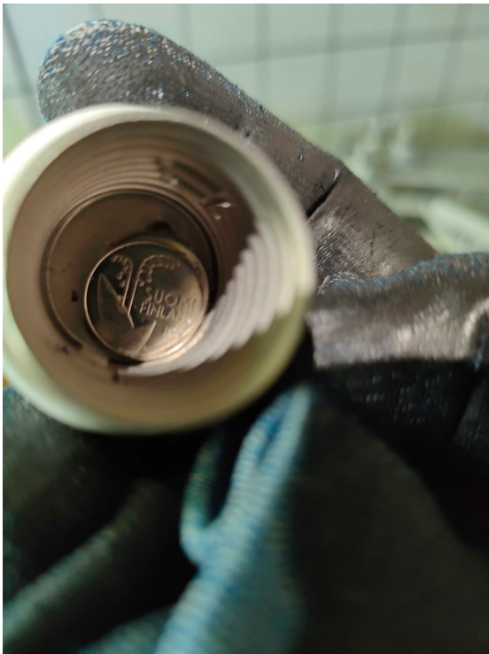
Kuva 29. Suomalainen kolikko sulakkeen alla korvaamassa puuttuvaa sulakepohjaa.
