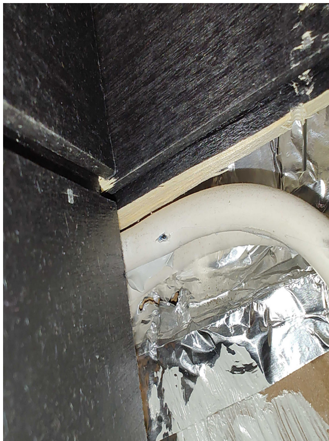
Kuva 2. Kiukaan kaapeli vaurioitunut.
