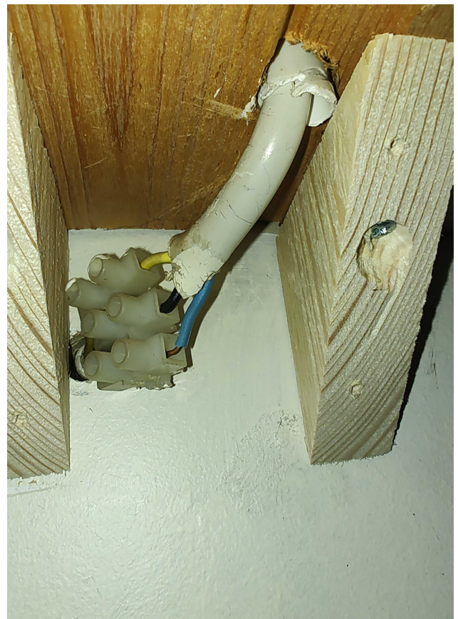
Kuva 13. Rasiaton liitos rakenteessa: johtimet suojamatta.
