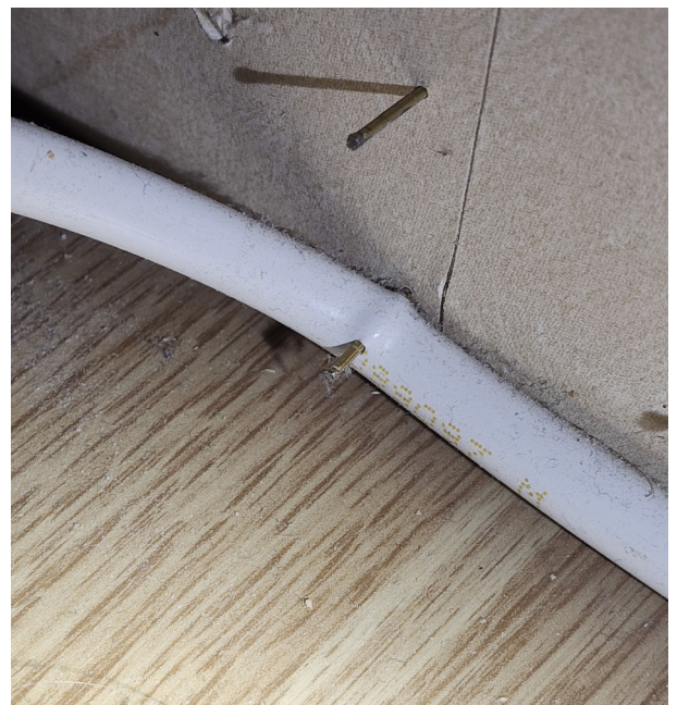
Kuva 35. Listakiinnike lyöty suoraan kaapelin läpi — 90-luvulta lähtien piilossa ollut riski.
