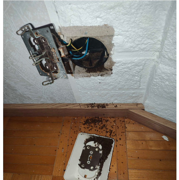
Kuva 31. Muurahaisyhdyskunta pistorasiassa — pistorasiasta paljastui myös löysän liitoksen sulattamia muoveja.
