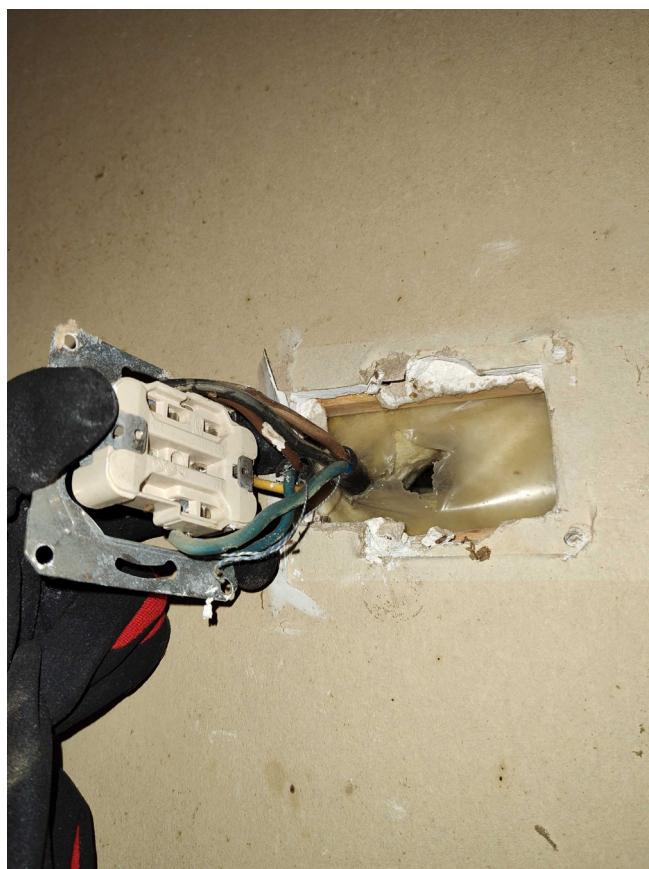
Kuva 11. Rasiaton uppopistorasia jossa johtimet suojaamatta.
