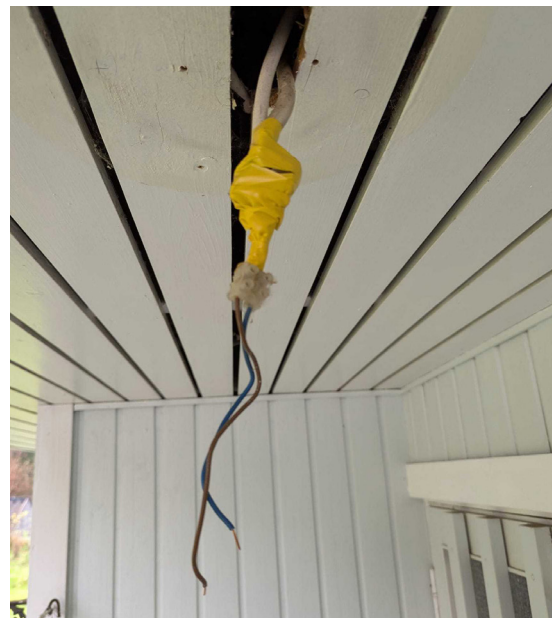
Kuva 27. Teipattu liitosjatkos ulkokaton alla roikkuvissa johtimissa.
