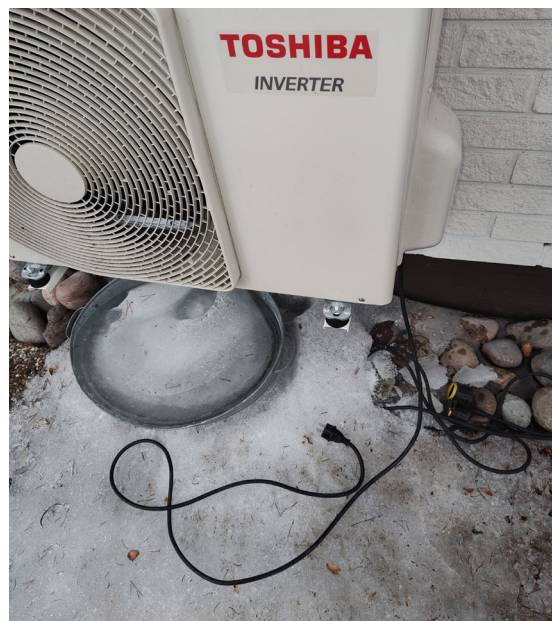
Kuva 23. Ilmalämpöpumpun jatkojohto jäässä ulkona.
