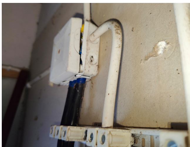
Kuva 5. Hajoamispisteessä oleva jakorasia, liitokset ovat rapistuneet ja rakenne hajonnut.
